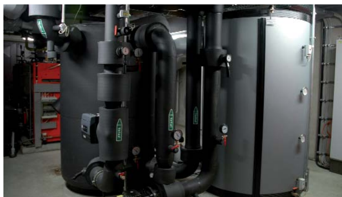
Die neue Heizzentrale
